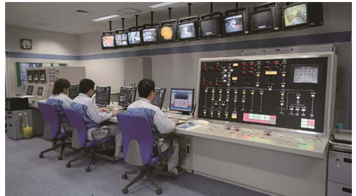
新門司工場の中央制御室
