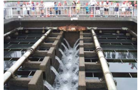
本城浄水場「ろ過池」
